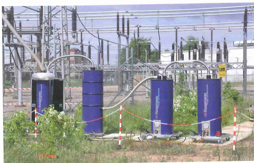
Bild 1. OWTS 200 kV mit allen Komponenten für eine Bewertung der Energiekabelsysteme
